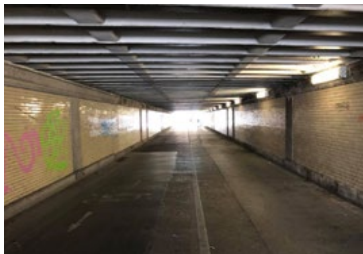
Der Karl-Bröger-Tunnel soll heller und freundlicher werden, das haben die Stadträtinnen und Stadträte 2018 beschlossen.
